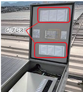
太陽光発電設備
